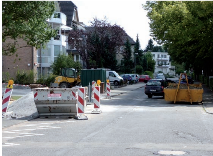
Bild 1: Mangelhafte Verkehrssicherung im Bereich der Fahrbahn (ungeschützter Container) und des Gehwegs (falsche und unzureichende Absicherung)
