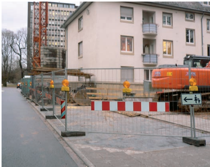
Bild 1: Ordnungsgemäß gekennzeichnete Bauzaun; Warnleuchten parallel zum Verkehr jedoch falsch (s. auch 1) )
