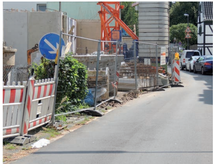
Bild 2: Bauzaun ohne Absperrkennzeichnung im Sinne der StVO
