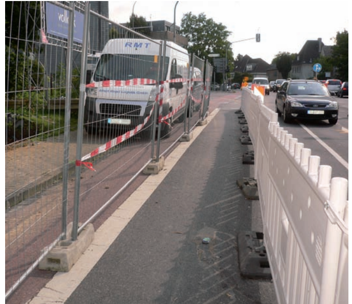
Bild 4: Kennzeichnung mit Warnband ist unzulässig
