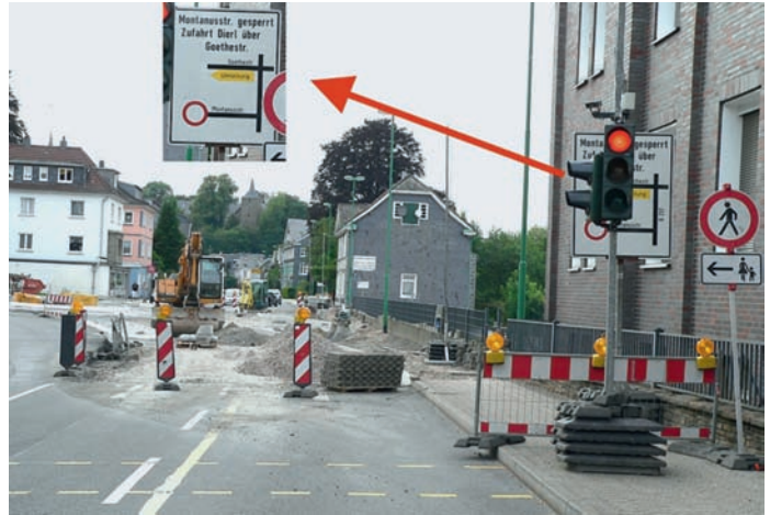
Bild 2: Umleitungsankündigung selbst bei Halt vor der Lichtsignalanlage nicht lesbar
