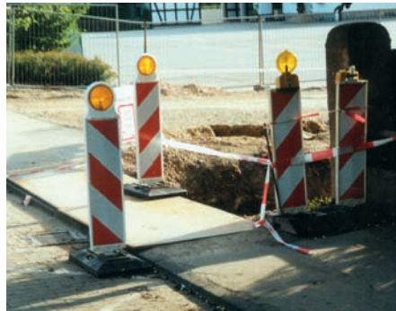
Bild 20: Fahrlässige Gestaltung einer Behelfsbrücke im Gehwegbereich
