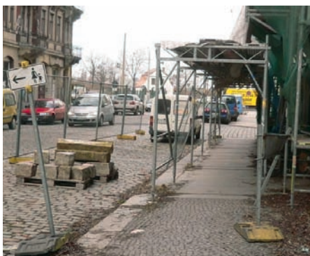
Bild 22: Ungesichertes Durchlaufgerüst mit Fehlweisung durch Zusatzzeichen
