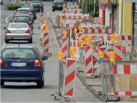
Bild 17: Fehlende Absperrung des Notgehwegs gegenüber dem motorisierten Verkehr
