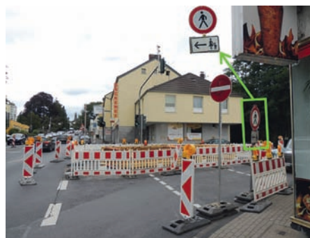
Bild 15: Tatsächlich keine Sperrung vorhanden, Überweg erkennbar nur verschoben
