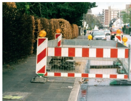
Bild 13: Unzulässige Absicherung mit Leitbaken im Gehwegbereich
