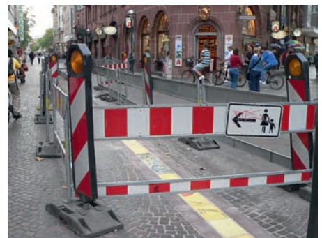
Bild 14: Unzulässige Absicherung mit Leitbaken und umstittene Anwendung des Zusatzzeichens
