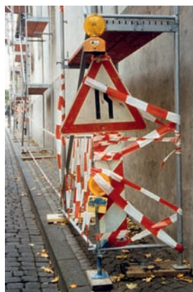
Bild 23: Unqualifizierte Kennzeichnung und Absperrung eines Gerüsts mit teilweiser Abdeckung des Verkehrszeichens und der Warnleuchte
