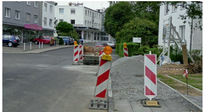
Bild 2: Nicht genehmigte, für Fußgänger falsche und gefährliche Absperrung (Dauer 1 Woche)
