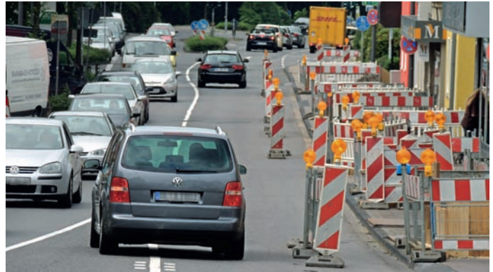
Bild 1: Verkehrsgefährdende Absperrung, fehlende gelbe Markierung (Dauer 4 Monate)
