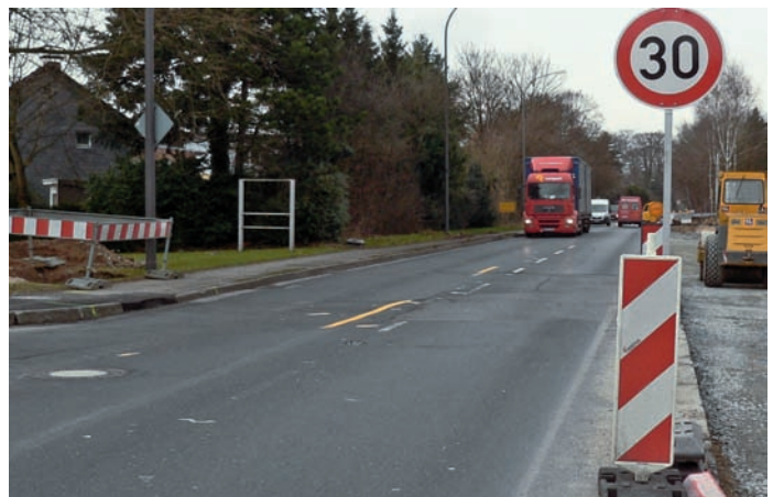
Bild 3: Verkehrsgefährdung durch mangelhafte gelbe Markierung (Dauer 3 Monate)
