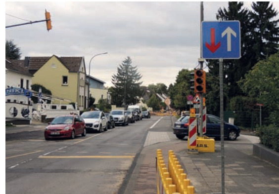
Bild 7: Überflüssige Beschilderung mit Zeichen 308 einer nicht mehr vorhandenen Einengung
