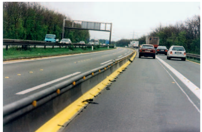
Bild 10: Gefährdung infolge mangelnder Reinigung
