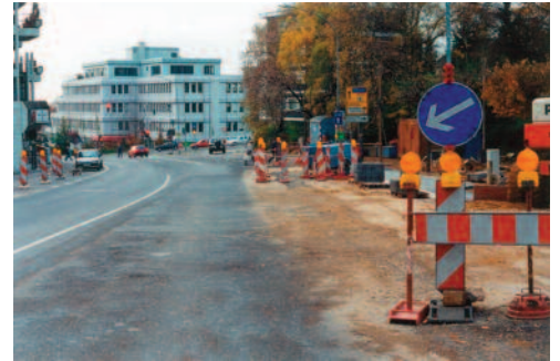
Bild 1: Zeitweise fehlende Sicherung zum Verkehrsraum
