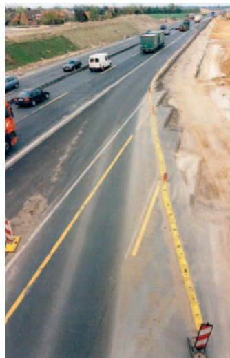
Bild 11: Verkehrsgefährdung infolge fehlender Demarkierung
