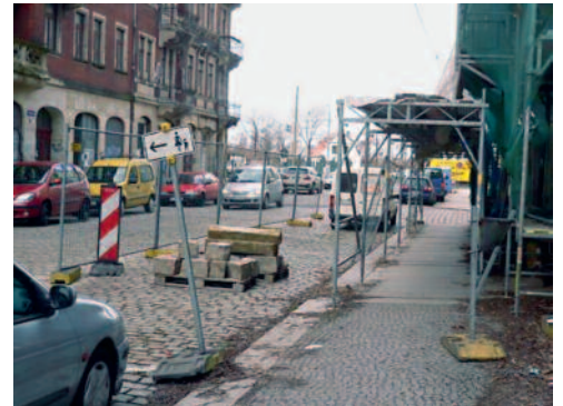
Bild 2: Fehlende Absperrungen, unklare Beschilderung
