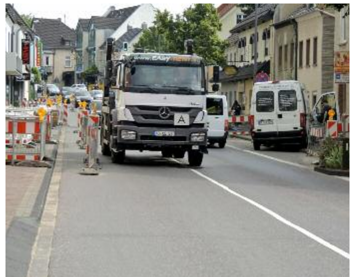
Bild 1: Infolge der Anordnung eines Notgehwegs hätten verengte Fahrstreifen markiert werden müssen. Die zuständigen Behörde hatte dies weder angeordnet noch ist ihr dies über die Bauzeit von drei Monaten aufgefallen.
