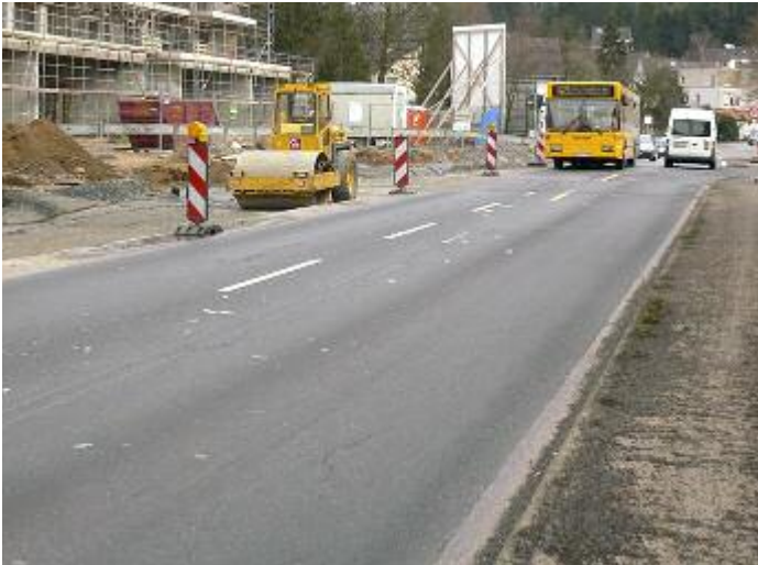
Bild 2: Die angeordneten Leitlinien für die verengten Behelfsfahrstreifen waren abgefahren, wodurch insbesondere bei Nacht gefährliche Begegnungssituationen entstanden. Erst nach einem Anruf bei der Behörde wurde nachmarkiert
