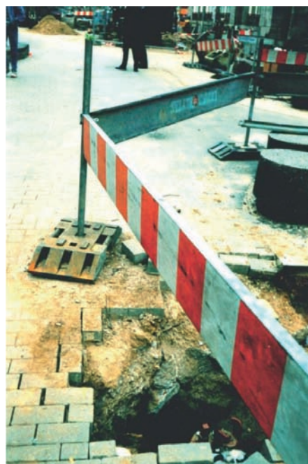
Bild 4: Mangelhafte Sicherung einer Baugrube
