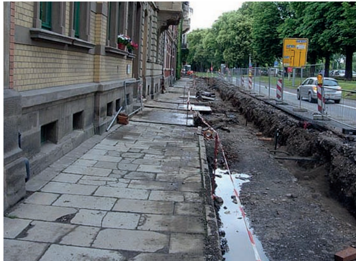
Bild 3: Mangelhafte Verkehrssicherung im Bereich eines Gehwegs [Korsch]
