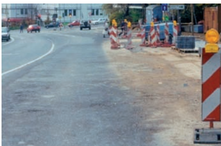
Bild 8: Fehlende Verkehrsführung infolge fehlender Leitbaken
