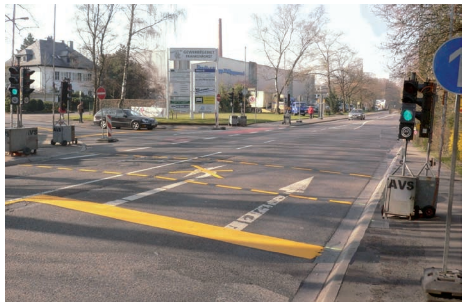
Bild 1: Transportable Lichtzeichenanlage mit Markierungen (Haltlinie, Fußgängerfurt)
