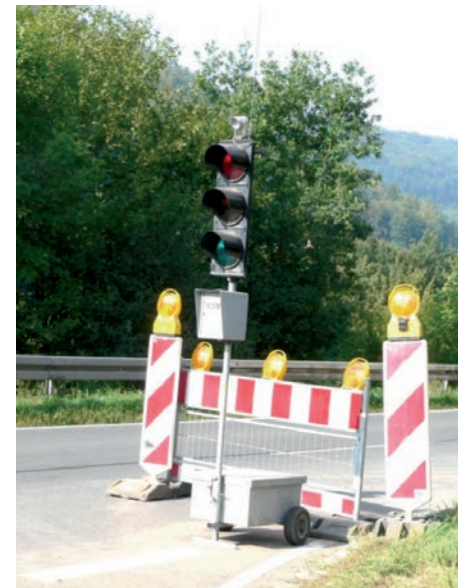
Bild 5b: Die LSA hinter dieser Einmündung ist so schlecht ausgerichtet, dass der einbiegende Verkehr die Lichtzeichen nicht erkennen kann
