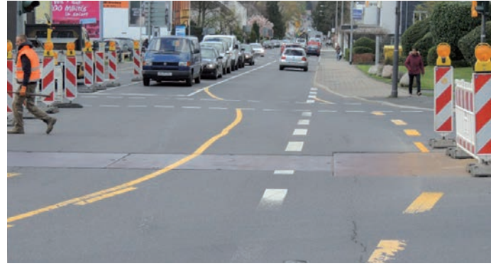
Bild 7: Unzulässiger Einsatz doppelseitiger Leitbaken links (zusätzlich teilweise falsche Schraffenrichtung)
