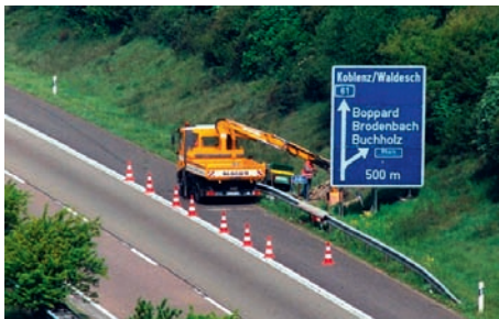
Bild 13: Fahrlässige Kennzeichnung einer Arbeitsstelle von kürzerer Dauer auf einer Autobahn
