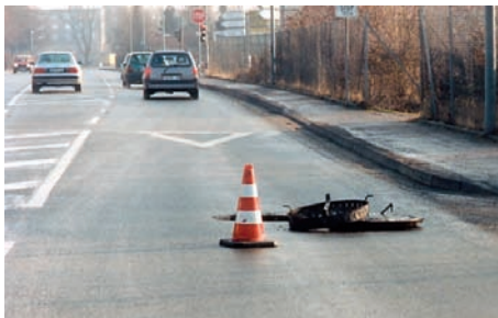
Bild 12: Fahrlässige Kennzeichnung einer Arbeitsstelle von kürzerer Dauer innerorts
