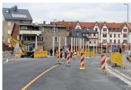
Bild 7: Falsche vorübergehende Markierung [Korsch]
