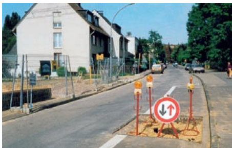
Bild 14: Unzureichende Absperrung und falsche Beschilderung
