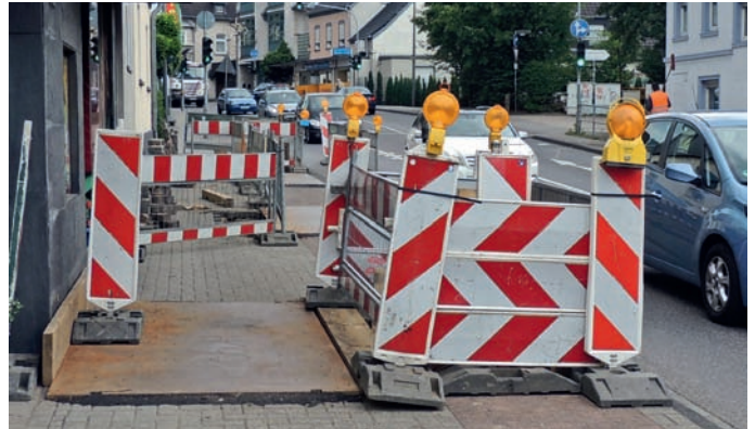
Bild 4: Unzulässige Absperrung mit Leitbaken auf dem Gehweg
