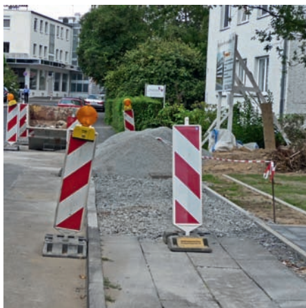
Bild 10: Lagerung im Gehwegbereich ohne korrekte Absperrung und Führung für die Fußgänger
