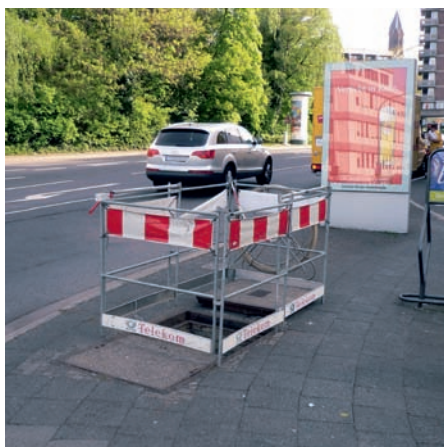
Bild 11: Absicherung eines Schachtzugangs
