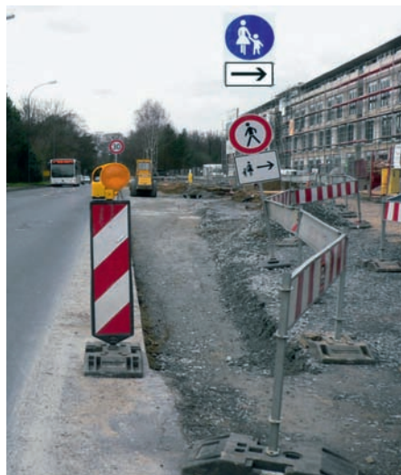
Bild 9: Notweg mit geschotterter Befestigung (Hinweis: korrekte Beschilderung oben)
